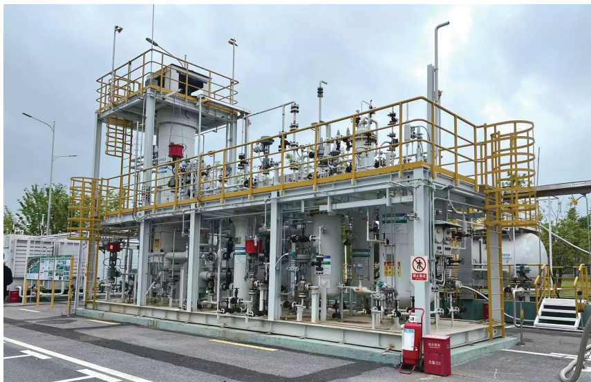
千吨级模块化柔性合成氨测试平台。
